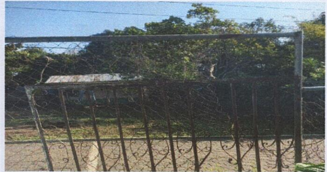
Foto 2: Malla perimetral en mal estado.
