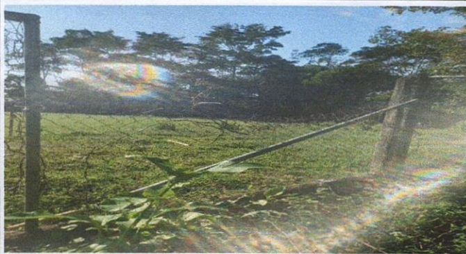
Foto 3: Estructura de circulación caída y en mal estado
