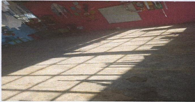
Foto 1: piso de torta con rajaduras y pedazos levantados en aulas y dirección del establecimiento
