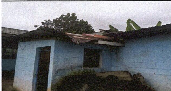
Foto 2: lamina en mal estado de la cocina
