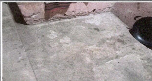
Foto 1: piso en mal estado en la cocina
