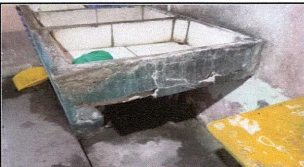
Foto 3: pila en mal estado de la cocina
