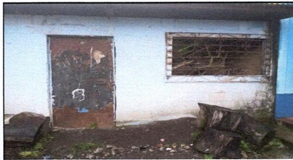
Foto 4: puertas en mal estado
