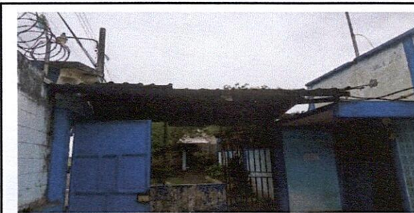
Foto 5: lamina en mal estado de la entrada principal del establecimiento
