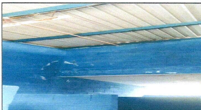
Foto 4: PAREDES CON FILTRACIÓN DE AGUA
