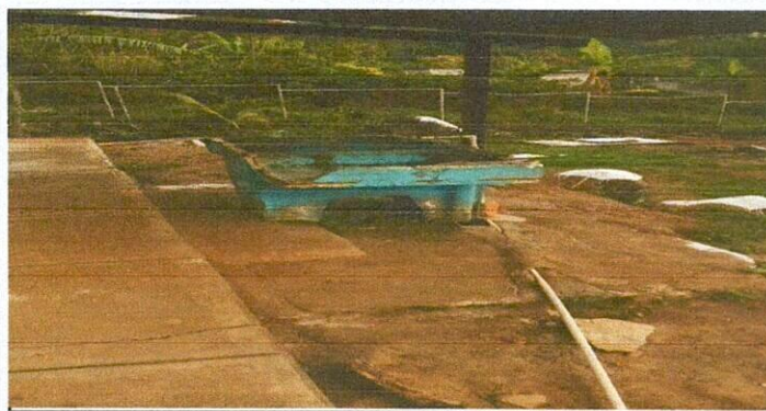
Foto 5: PILA EN MAL ESTADO, EN COCINA
