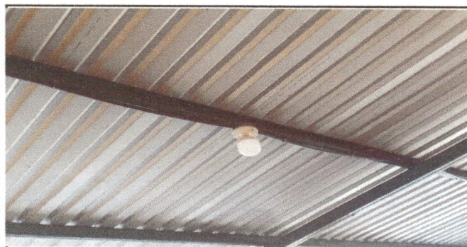
colocacion correctas de plafonerias
