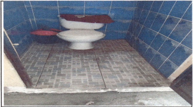
Sanitario en mal estado
