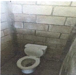
Foto 3: Area de accesorio de sanitario
