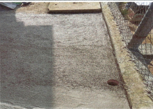
Foto 3: culminación de nueva losa por losa existente por hundimiento lado derecho de los sanitarios
