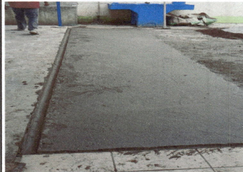
Foto 2: culminación de nueva losa por losa existente por hundimiento del lado frontal de los sanitarios
