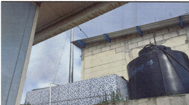
Foto 4: Techado de pila por falta de agua la pila se encuentra vacía y el sol la daña y es trabajo de antiguos remozamientos.
