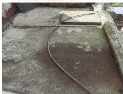
Foto 3: losa lateral derecho de los baños con hundimiento a la par del muro perimetral
