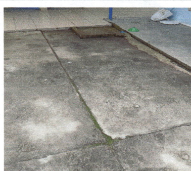
Foto 2: losa hundida frente a los baños
