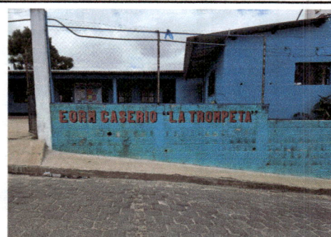
Foto 6: Área externa con pintura deteriorada.
