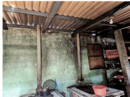
Foto 4: Cocina con pintura en mal estado
