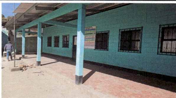
Foto 5: Áreas externas con pintura deteriorada.
