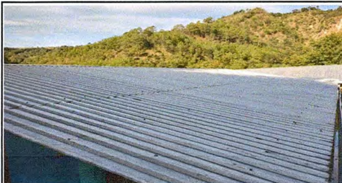
Foto 20: Mantenimiento de goteras en aulas.
