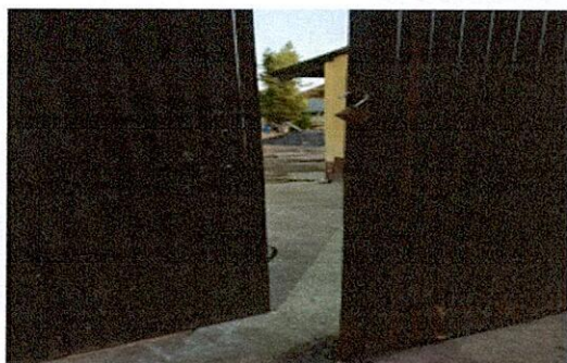
Foto 3: Evidencia del deterioro del portón.
