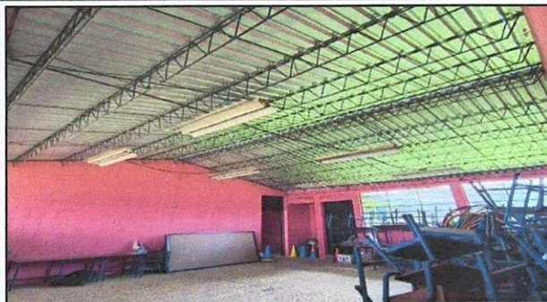
Foto1: Instalación eléctrica Salón 1
