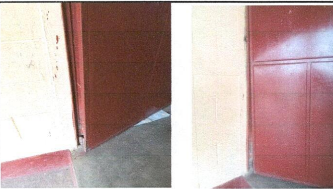
Foto 3: Puertas de direccion y segundo primario en mal estado
