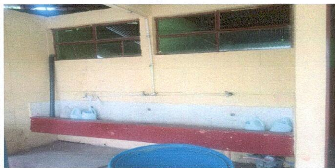
Foto 5: Lavamanos en mal estado
