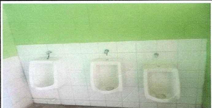
Foto 6: Llaves de uriniales en mal estado
