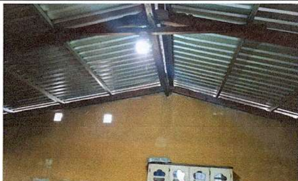
Foto1: Se necesita levantado de pared en la cocina
