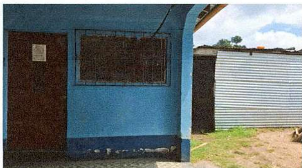
Foto 3: Se necesita ampliar la cocina
