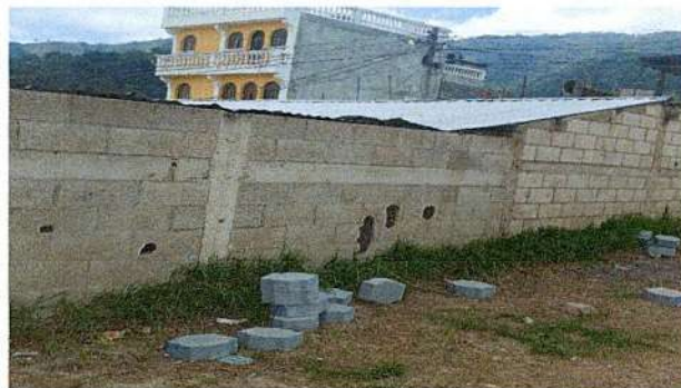
Foto 2: Se necesita levantado, resonado y cernido de pared exterior
