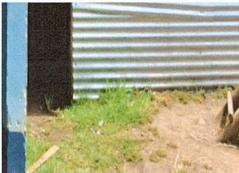
Foto 9: Se necesita alisado de piso en la ampliación de la cocina.
