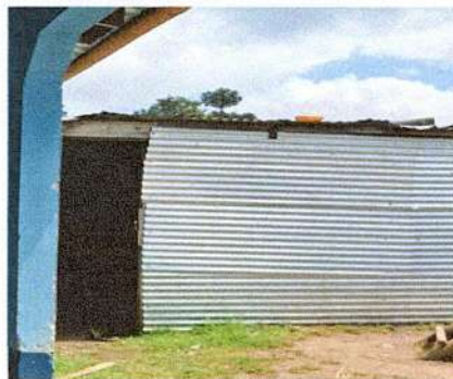
Foto 4: Se necesita techado en la ampliación de cocina
