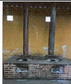
Foto 6: Se necesita reparar el fogón doble.
