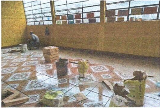
Foto 1: cambio de piso para un aula, la cual tiene una parte de torta y itra con piso granito dañado.
