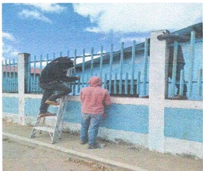
Foto 1: es necesario repintar las rejas de circulacion de la fachada de la escuela
