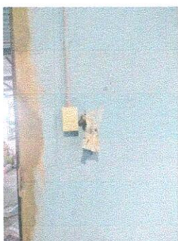
Foto 3: Conexión de energía eléctrica en un aula.
