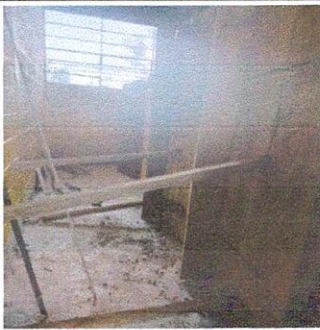
Foto 3: trabajos de reforzamiento en los pines de los servicios sanitario ya que algunas puertas estan por caerse.
