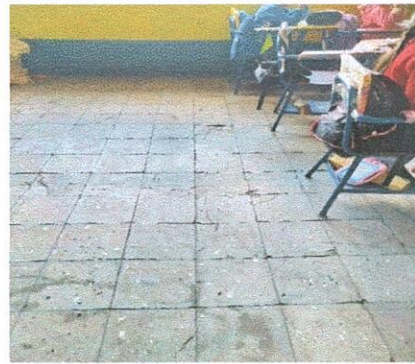
Foto 2: Se realizara cambio de piso en un aula la cual esta undida y agrietada.
