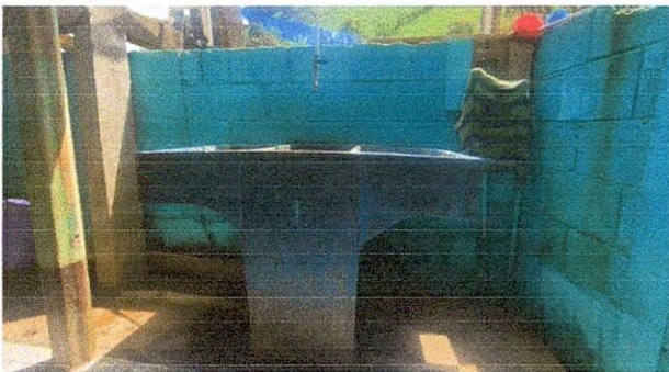
Foto3: Servicios sanitarios y accesorios: se desocupará el área.
