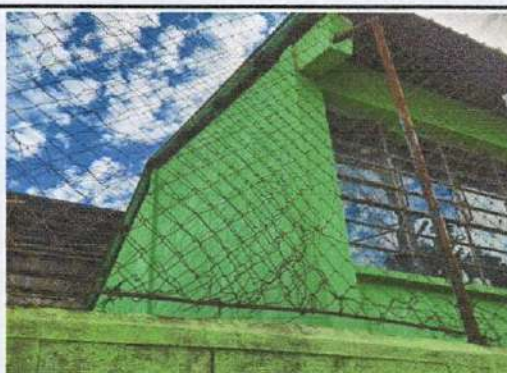
Foto 4: El cerco ya no cumple con su funcionalidad.
