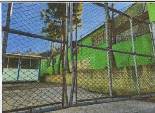
Foto 5: Los tubos del portón están doblados y quebarados.
