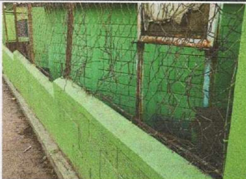
Foto 1: Se requiere cambio de malla del cerco perimetral deteriorado.
