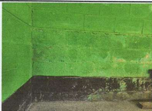
Foto 3: Las paredes del salón de primero A, están dañadas por la humedad.
