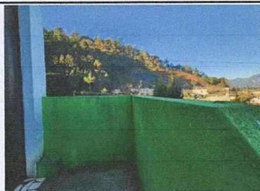
Foto 4: Se requiere instalación de baranda en el tercer nivel ya que la pared es muy baja, se constituye un riesgo.
