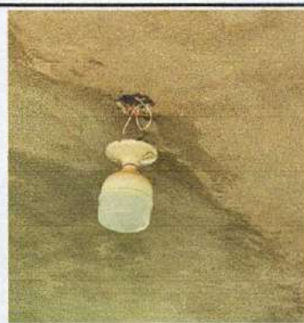
Foto 6: Se tienen plafoneras que ya no son funcionales.
