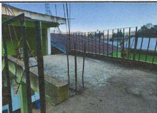
Foto 3: En ésta área carece de baranda.
