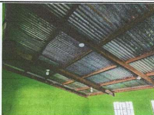
Foto 2: Se requiere cambio de costaneras de madera por costaneras galvanizadas.
