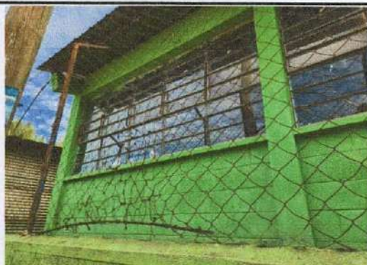
Foto 3: Varias partes del cerco tiene remiendos con alambre de amarre.
