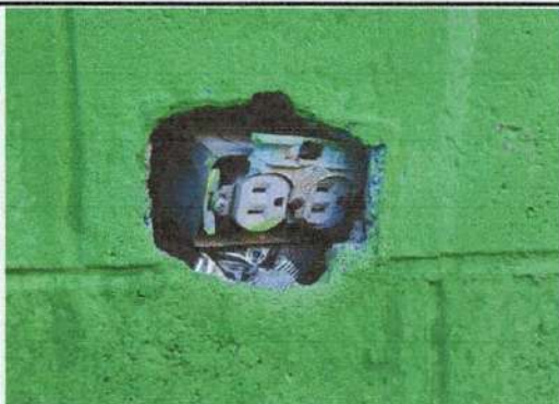
Foto 4: Algunos tomacorrientes ya no son funcionales, y otros presentan riesgo.
