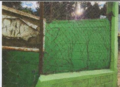
Foto 2: La malla del cerco ya no está en condiciones adecuadas.
