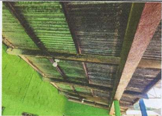
Foto 1: La lámina esta oxidada y picada, requiere cambio. También se requiere cambio de capote.
