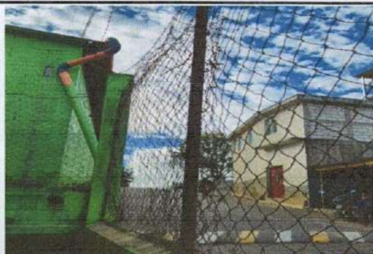
Foto 5: Los alambres salidos de la malla representan riesgos.
