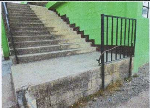
Foto 1: La baranda está incompleta y se mueve.
