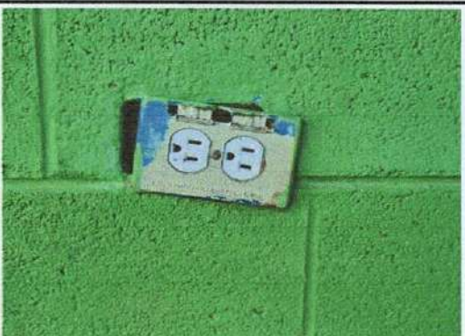
Foto 3: Los tomacorrientes están quebrados y fuera de su lugar.
