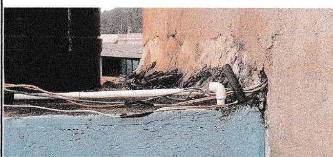
Foto 2: Instalación eléctrica a reparar del bloque 1 de aulas de la escuela.
