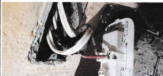
Foto 5: Instalación eléctrica en mal estado en los salones de clases.
