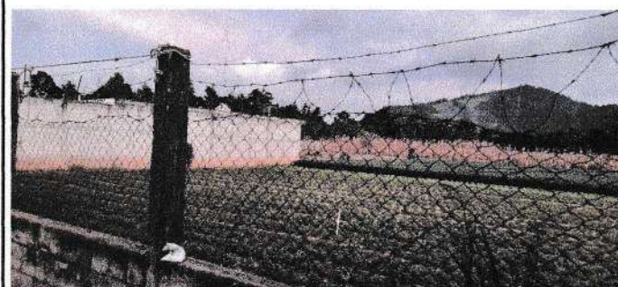
Foto 4: Pared que será remozado para seguridad de los estudiantes.
