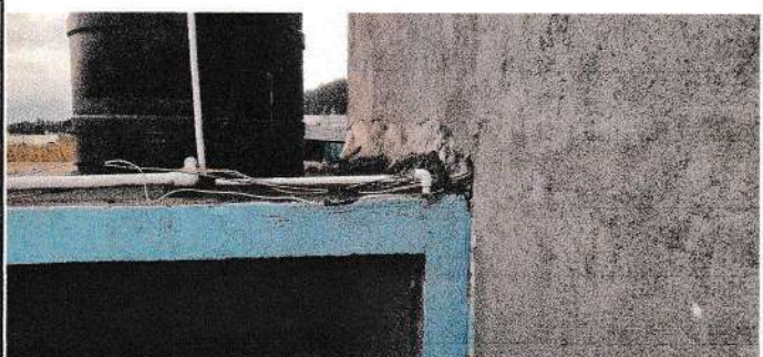
Foto 3: Cables que han sufrido corto circuito por mala instalación.
