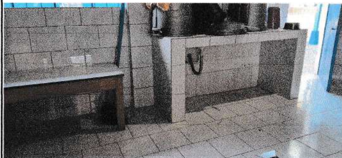
Foto1: Actualmente se cuenta con un lavatrastos que no es funcional en la cocina de la escuela y no esta en uso.
