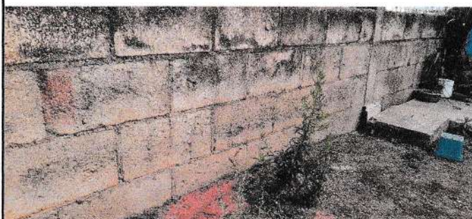
Foto 2: Pared en malas condiciones que se repellará.
