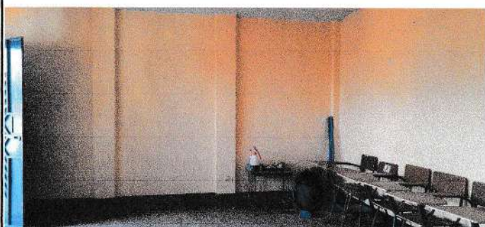
Foto 3: La pintura en los salones de clases esta en regulares condiciones.
