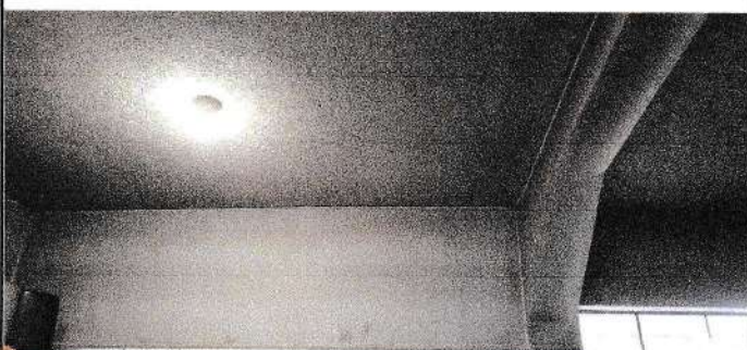
Foto 5: Un ambiente en la escuela se encuentra en malas condiciones.
