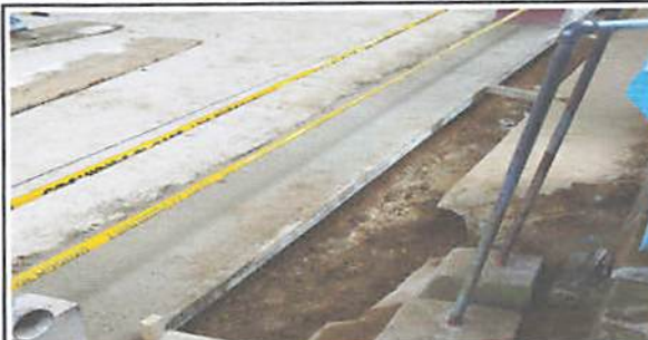
Foto 2: cunetas para salida de agua.
