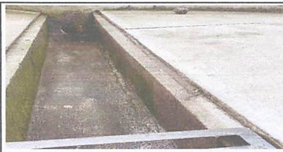
Foto 6: Sustitución de rejilla de metal para evitar accidentes.
