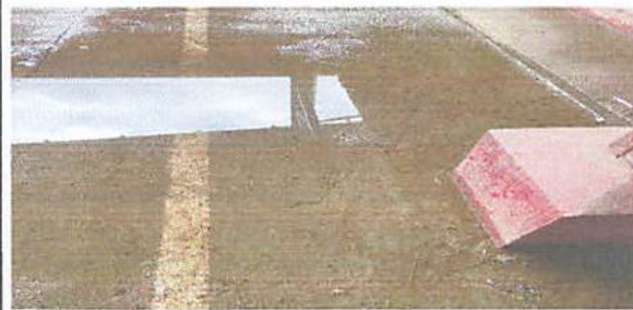
Foto 2: Es necesario elaborar cunetas para salida de agua.
