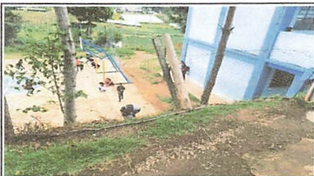
Foto 5: Remplazar malla de la parte de la cancha, para mayor seguridad
