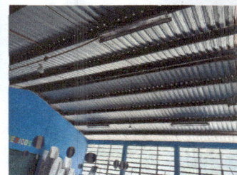
Foto 4: La electricidad dentro de los salones se encuentra en muy mal estado, así que se requiere arreglarlo.
