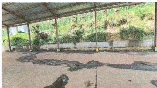
Foto 2: debido al mal estado de las bajadas de agua se inundan la cancha y aulas
