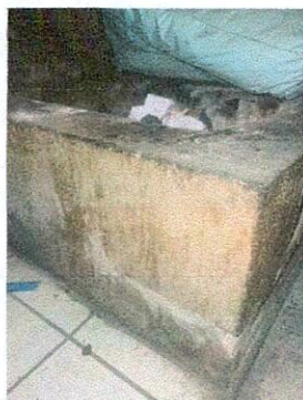
Foto 3: planchas en mal estado de la cocina
