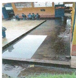
Foto 6: bajadas de agua pluvial en mal estado
