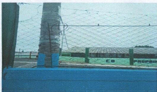
Foto 5: Reglón No.15 Cerco o muro perimetral
