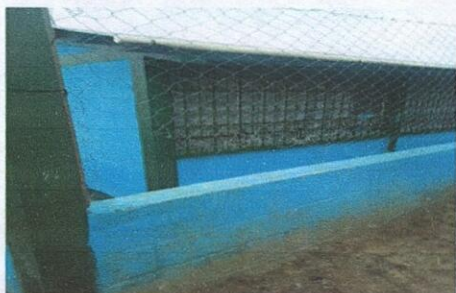
Foto1: Reglón No. 15 Cerco o muro perimetral
