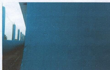
Foto 6: Reglón No. 15 Cerco o muro perimetral
