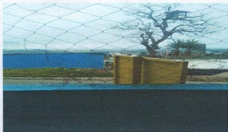
Foto 3: Reglón No.15 Cerco o muro perimetral
