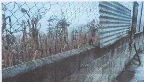
Foto 1: falta de muro perimetral para la seguridad de comunidad educativa
