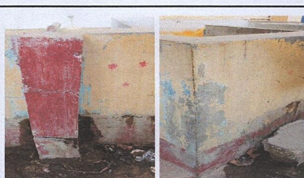
Foto 4: La pila necesita mantenimiento y reparación, ya que el agua se filtra.
