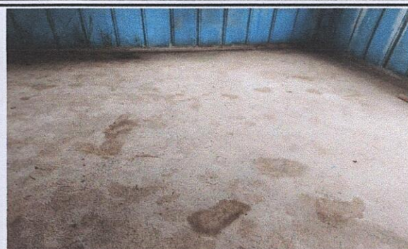
Foto 2: El piso no es el adecuado para un salón de clases y esta agrietado
