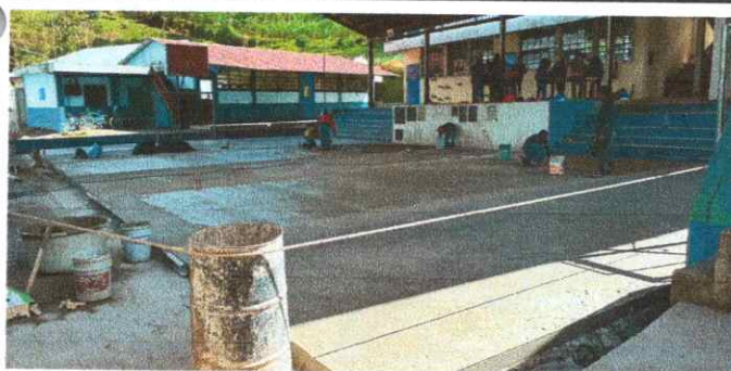
Foto 5: Fundición de losa "Pavimento en mal estado, necesario su reposición".
