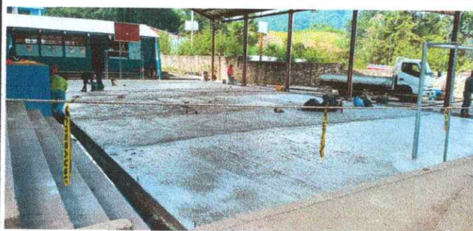
Foto 3: Fundición de losa "Pavimento en mal estado, necesario su reposición".
