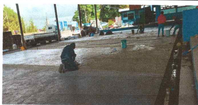
Foto 4: Fundición de losa "Pavimento en mal estado, necesario su reposición".
