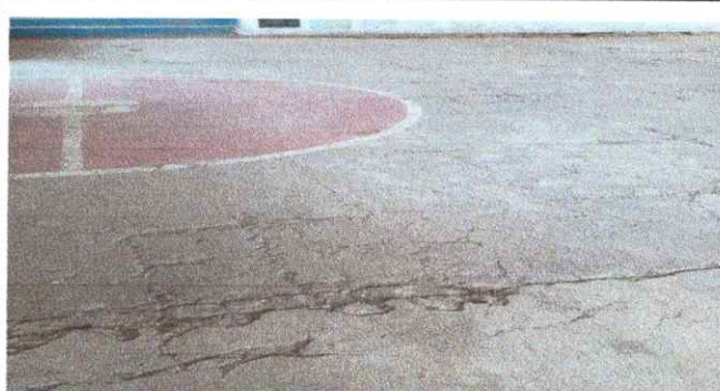
Foto 4: Fundición de losa "Pavimento en mal estado, necesario su reposición".
