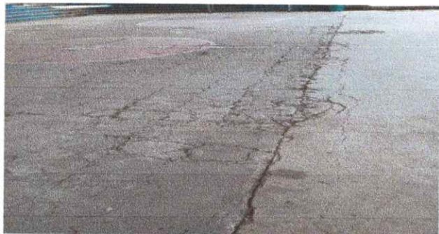
Foto 1: Fundición de losa "Pavimento en mal estado, necesario su reposición".
