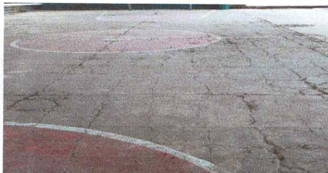
Foto 3: Fundición de losa "Pavimento en mal estado, necesario su reposición".
