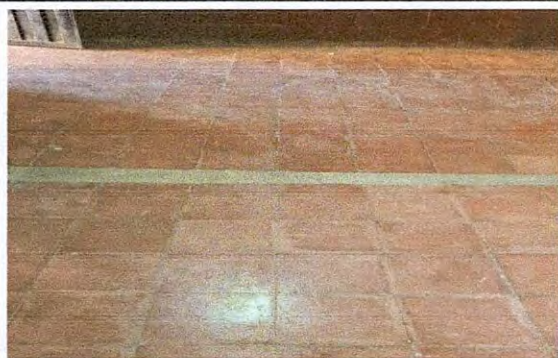
Foto 5: Falta de colocación de piso
