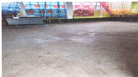
Foto 5: Piso deteriorado por el paso del tiempo.
