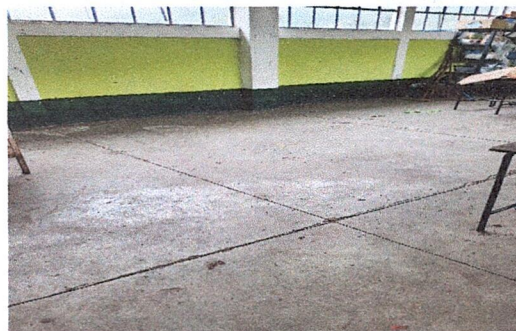
Foto 4: Piso con capa levantada.
