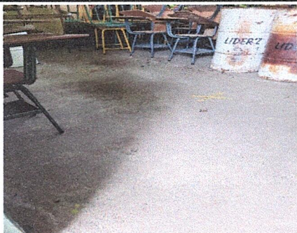
Foto 1: Piso deteriorado por el paso del tiempo.
