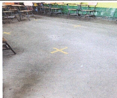
Foto 2: Piso con rajaduras.
