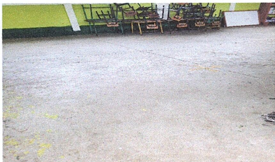
Foto 3: Piso con rajaduras.
