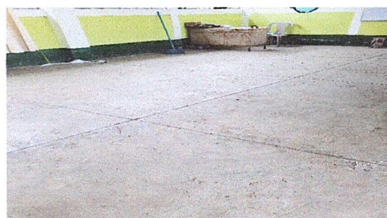
Foto 6: Piso con rajaduras.
