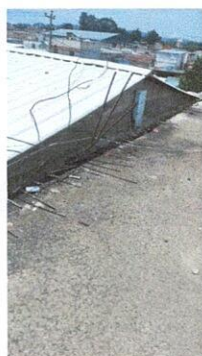
Foto 3: Impermeabilización de loza de dos salones del área de CONACE
