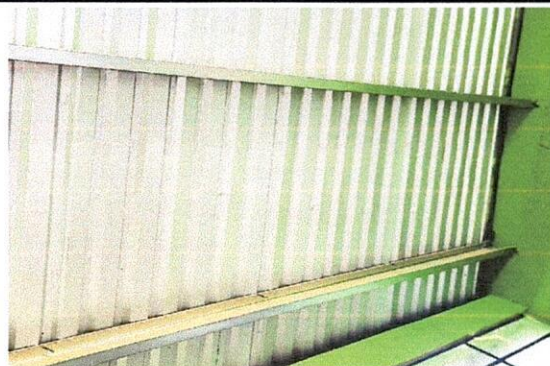
Foto 2: El remachado de las láminas eliminó pequeñas aberturas entre láminas y por ende las filtraciones.
