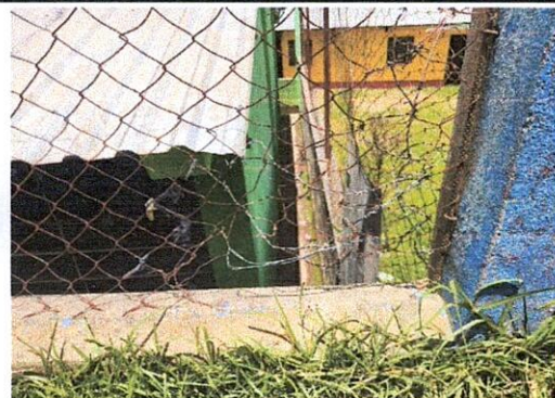
Foto 3: La malla está rota.
