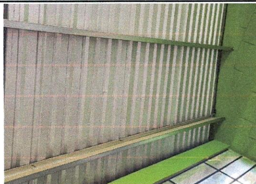
Foto 2: Se requiere remachar las uniones de láminas.
