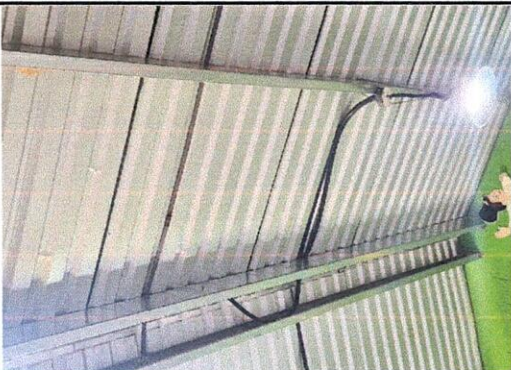
Foto1: La lámina está mal traslapada y por eso hay filtraciones en los salones cuando llueve.
