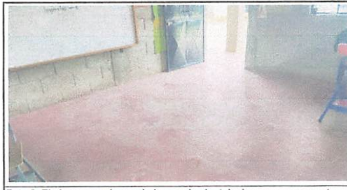
Foto 6: El piso no es el apropiado para las instalaciones y se encuentra en malas condiciones.
