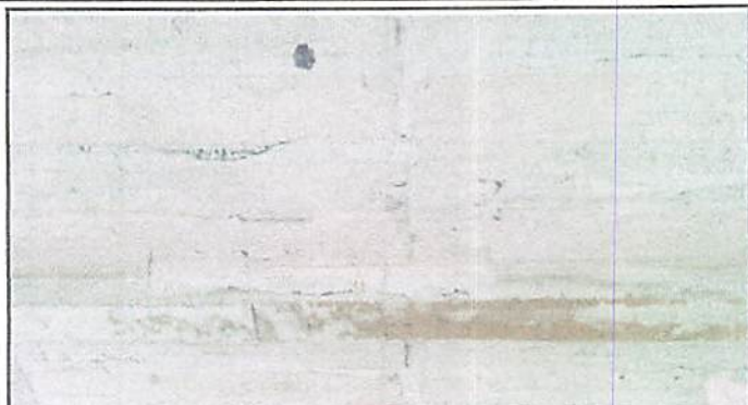
Foto 1: A las vigas y techado les falta el acabado y tallado.
