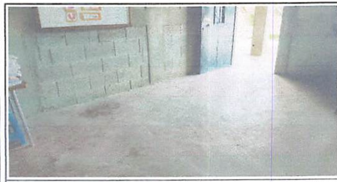
Foto 5: El piso no es el apropiado para las instalaciones y se encuentra en malas condiciones.
