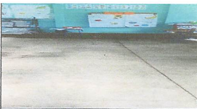
Foto 6: En el siguiente salón también logramos verificar lo deteriorado que se encuentra el piso.
