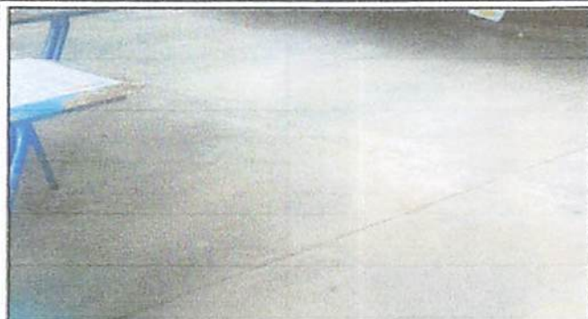
Foto 1: La presente imagen es de un salón, la cual se encuentra en mal estado.
