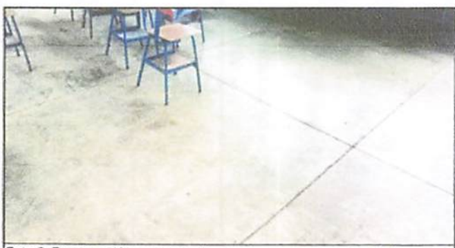
Foto 5: En este salón vemos lo deteriorado que se encuentra el piso.
