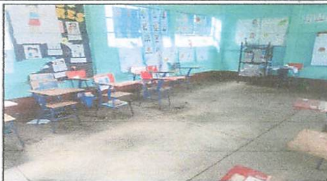
Foto 2: En este salón se encuentra deteriorados varias partes.
