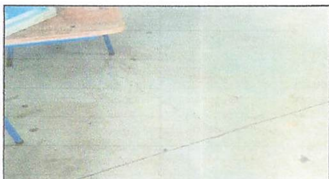
Foto 3: En este salón verificamos y se observa la parte deteriorada.
