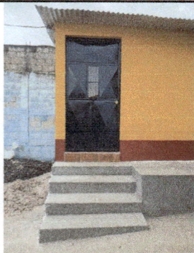
Foto 1: Vista frontal de puerta y gradas de ampliación de cocina.
