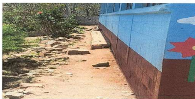
Foto 4: Aulas que se pueden quedar en el área por falta de un muro de contención
