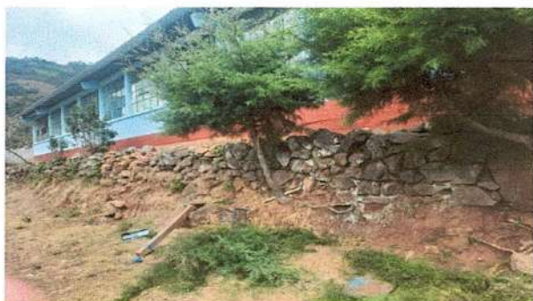
Foto 3: muro de piedra que se esta desprendiendo
