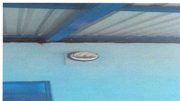
Foto 2: no se cuenta con instalaciones electricas
