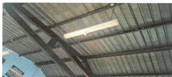
Foto 4: En todo el edificio se reparar el sistema electrico, porque se encuentra en mal estado
