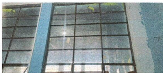
Foto 3: Debido a la situacion actual de los vidrios de la ventana se procedera a cambiarlas para mejorar el ambiente escolar en el salon de Turismo.
