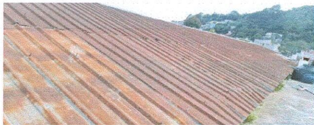
Foto 1: Es importante el cambio de la lamina del techado del segundo nivel del edificio la cual mide 45 m de largo y 16 m de ancho
