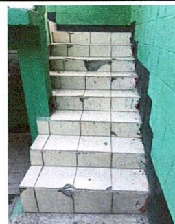
Foto 4: Se necesita la reparación de piso en gradas.
