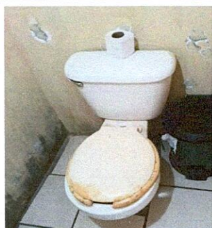
Foto 5: Se necesita remplazar los sanitarios.
