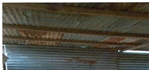
Foto 2: Se necesita cambiar el techo de la cocina.
