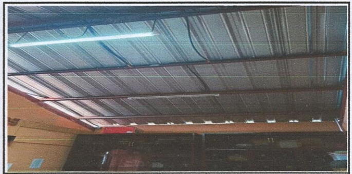
Foto 4: El módulo de dirección con necesidad de un cielo falso para evitar el deterioro de documentos por la filtración de polvo y lluvia
