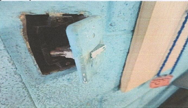
Foto 3: Necesario mejorar las líneas principales y apagadores del sistema eléctricos de las aulas
