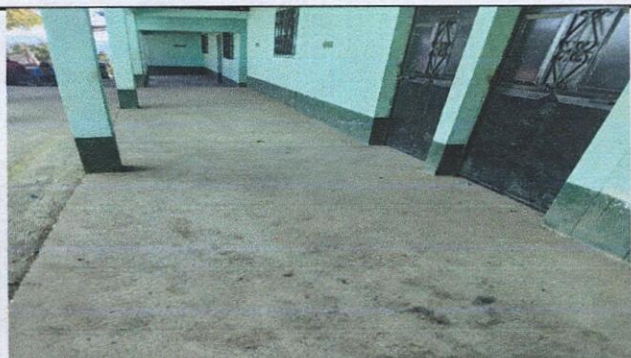
Foto 3: El piso de la cocina, corredores y dentro de los salones de clases está deteriorado, afecta a los estudiantes a recibir su alimentación escolar e incomodidad al realizar la limpieza.
