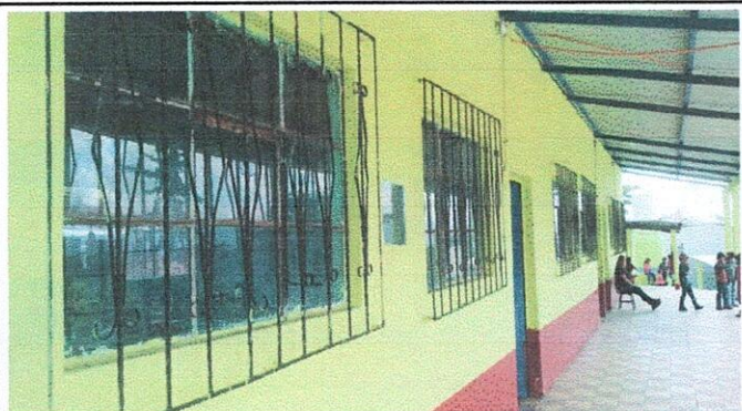
Sustitución de ventanas y balcones por mal estado y deterioro de materiales.
