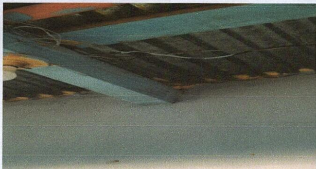
Foto 1: Cables en mal estado en toda la instalación eléctrica.
