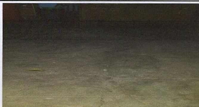
Foto 4: piso deteriorado de modulo 2
