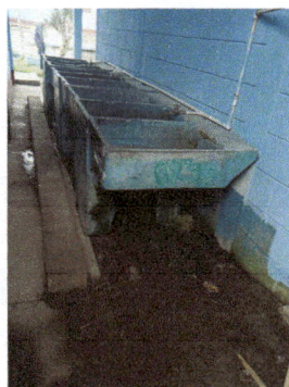
Foto 3: Area inadecuada y deteriorada para los estudiantes del nivel Párvulos.
