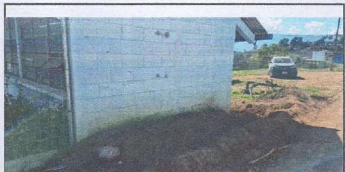
Foto 6: Necesidad de Protección de un Talud para la cocina
