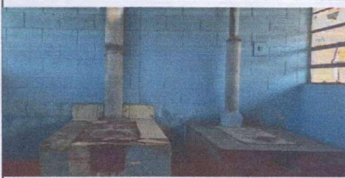
Foto 3: Deterioro de estufas de leña
