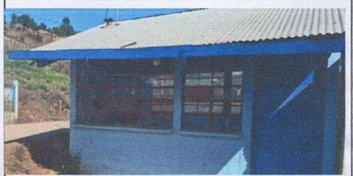
Foto 4: Necesidad de colocación de ventanas
