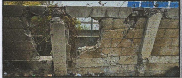
MURO DE CONTENCIÓN COLAPSADO
