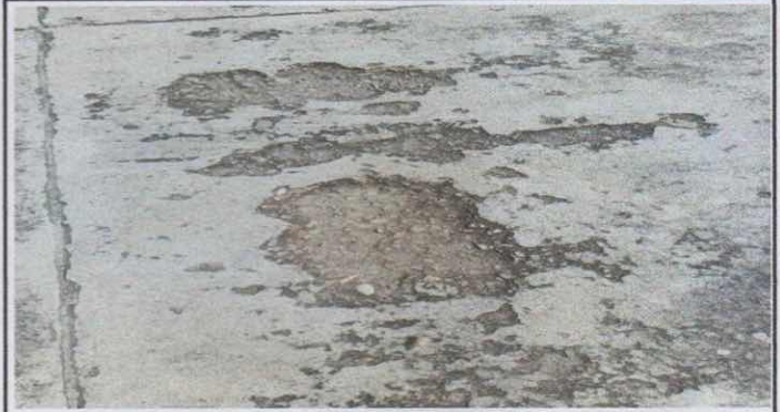
SUSTITUCIÓN DE PAVIMENTO POR MAL ESTADO
