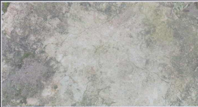
SUSTITUCIÓN DE PAVIMENTO POR MAL ESTADO
