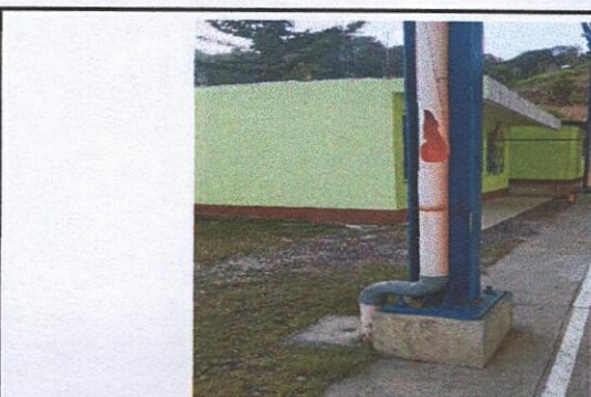
Canales y bajadas de agua deficientes
