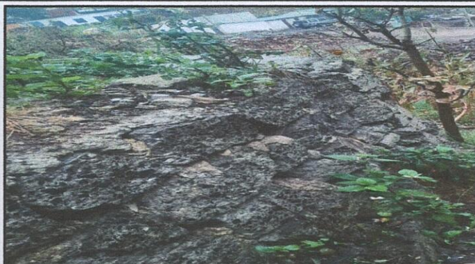
Es urgente y necesario sustituir este muro de contención para la seguridad de la infraestructura y del estudiantes
